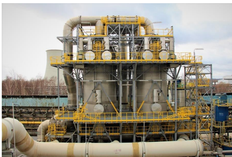
Elektrofiltry mokre – Wydział Pieca Elektrycznego i Konwertorów Huty II
