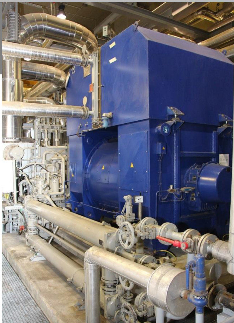
Zespół turbogenerators TG -7
